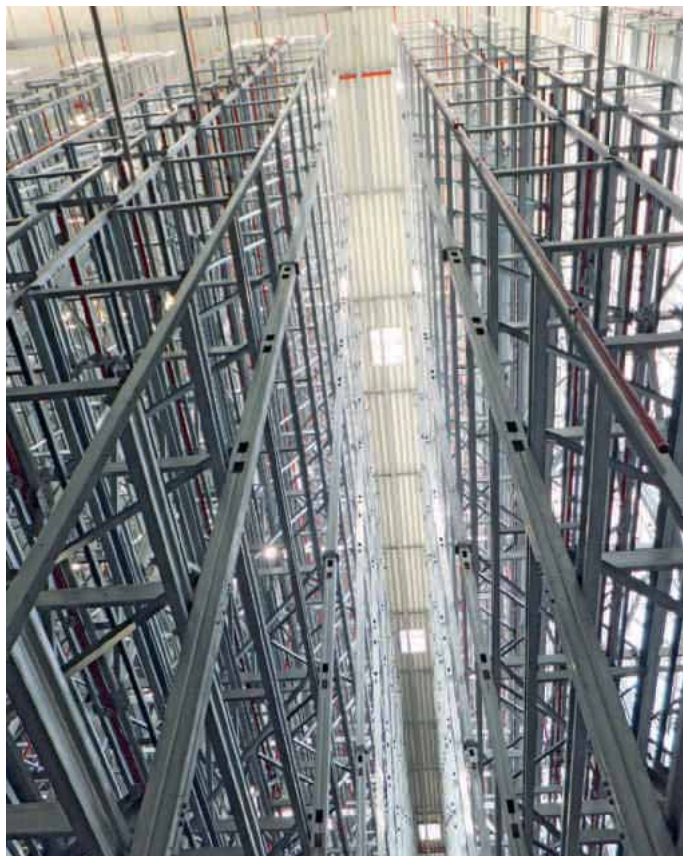
Rittals neues Hochregallager am Standort Haiger verfügt über eine Gesamtkapazität von 25 000 Palettenstellplätzen. (Fotos von Kocher Regalbau)
